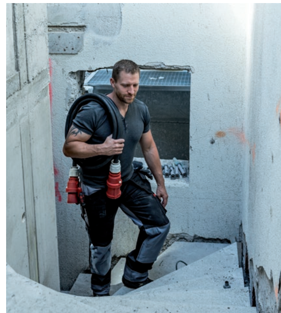
Auf der Baustelle kommt auch Starkstrom zum Einsatz. Entscheidend dabei ist die sichere Verteilung. (Fotos: Brennenstuhl)
